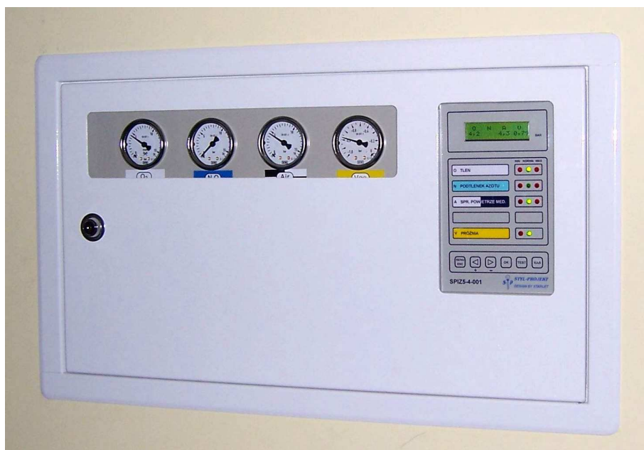
Rys. nr 5 : Strefowy punkt informacyjno – zaworowy SPIZ5-4-001, widok ogólny
